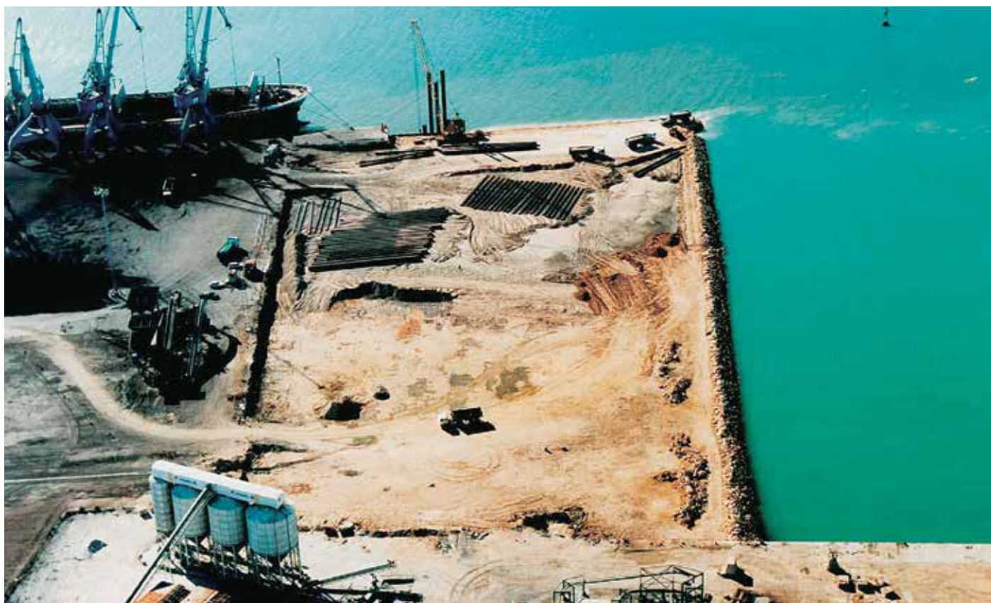
Был выбран вариант расширения бетонного причала за счет шпунтовых свай благодаря экономической выгоде при их использовании.
