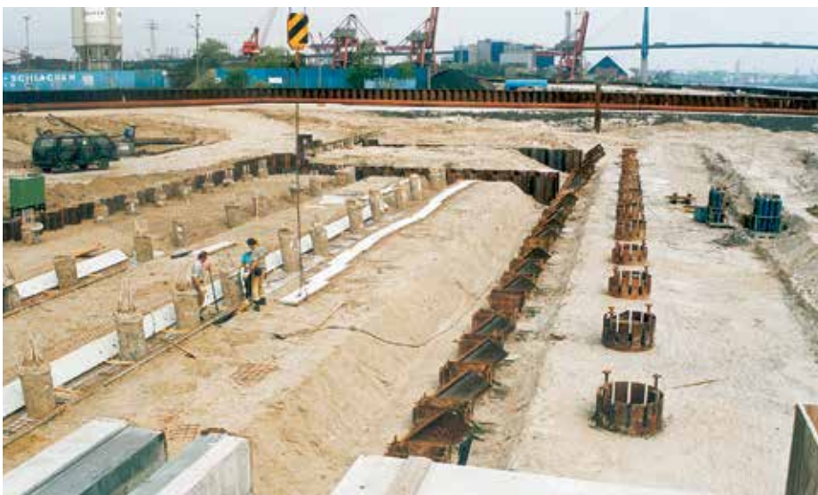
Устройство плиты разгрузочной эстакады поверх лицевой и задней шпунтовых стенок, стальных свай, работающих на растяжение, труб отбойников и бетонных свай.
