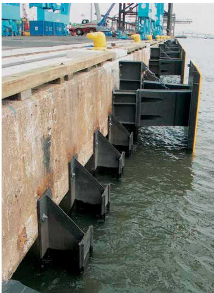
... а также обеспечило идеальную опору для отбойников на терминале.
