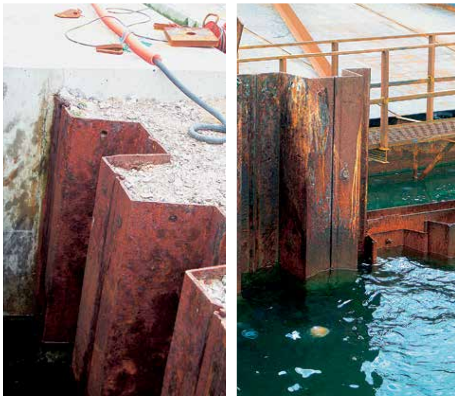
Узел А: Конец бетонного оголовка старого Восточного контейнерного терминала. Существующие шпунтовые сваи Восточного контейнерного терминала установлены еще на несколько метров после бетонного оголовка.
