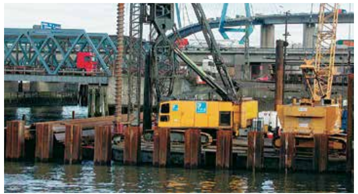
В силу крайне сложных грунтовых условий было принято решение о предварительном бурении для того, чтобы облегчить установку AZ-свай.
