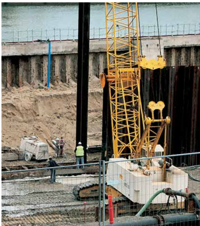
Погружение шпунтовых свай в бентонитовую траншею (стена в грунте) с использованием простого кондуктора.
