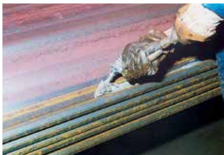
Заполнение в условиях цеха замковых соединений герметизирующей системой, расширяющейся при контакте с водой.
