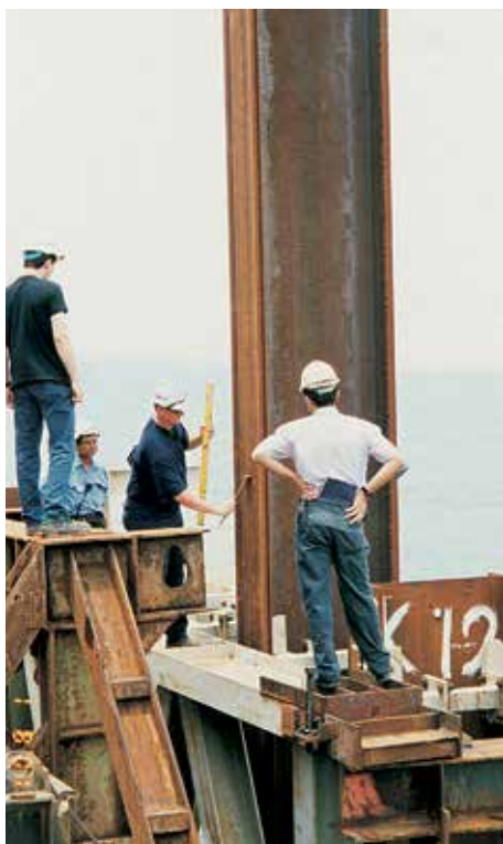
Для проведения консультаций на этапе погружения свай ArcelorMittal направил двух своих инженеров.
