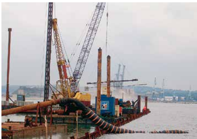
Кран поднимает анкерную тягу вместе с анкерными плитами для установки на глубине 11 метров.
