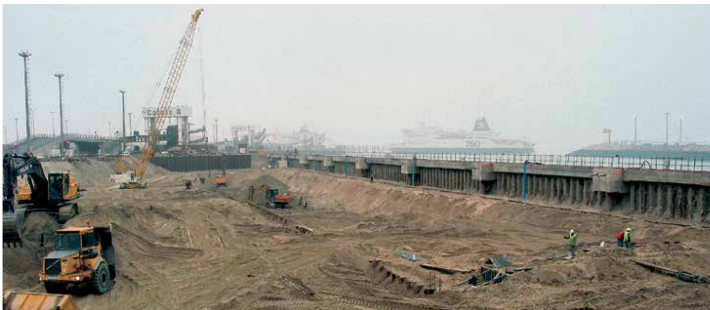
Благодаря существующей причальной стенке из шпунта типа PU 25 погружение новой стенки происходило с суши
