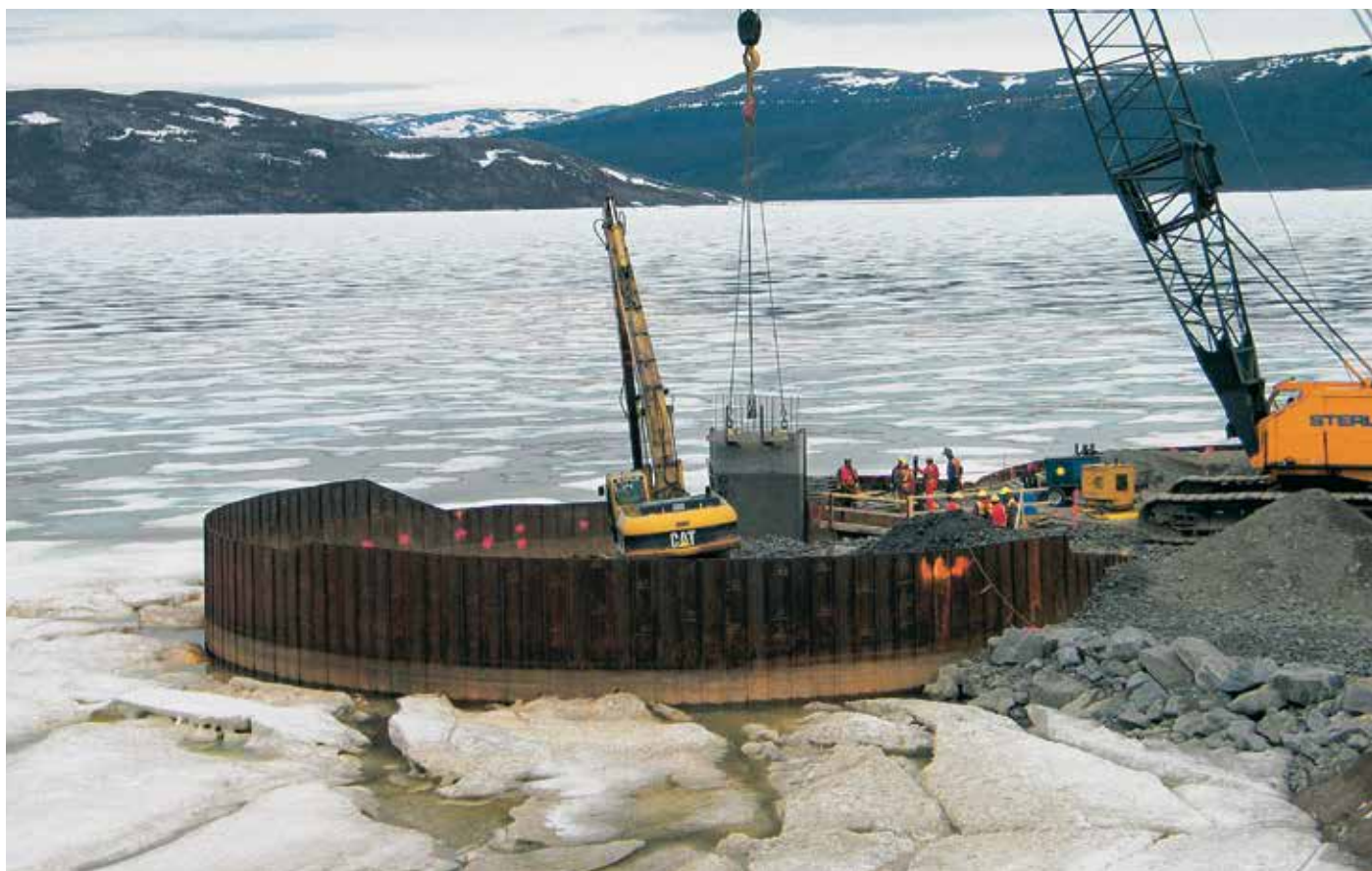
Проект ячеек большого диаметра из шпунтовых свай должен был учитывать нагрузки от давления льда.
