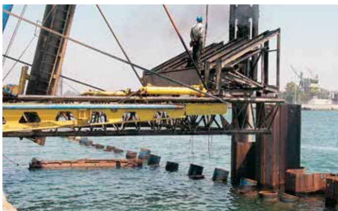
Кондуктор состоял из двух уровней направляющих из стальных труб, оборудованных резиновыми накладками.
