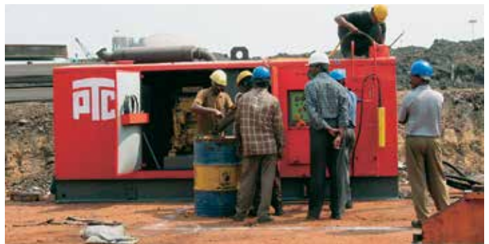
Силовой блок вибропогружателя PTC.
