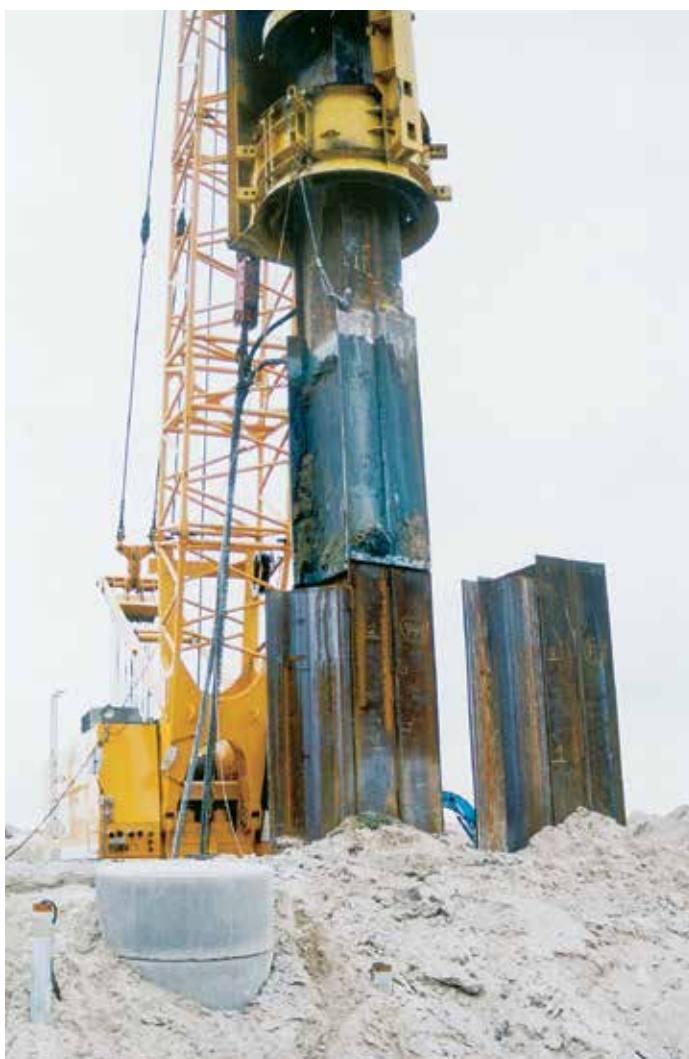
Тяжеловесные шпунтовые сборные элементы забивали на глубину 30,5 м с помощью ударного молота.
