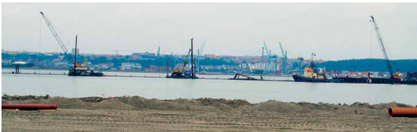
На сооружение лицевой причальной стенки протяженностью 1170 м пошло порядка 4000 тонн свай PU 32 разной длины.
